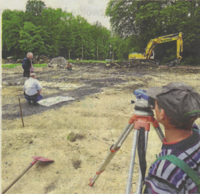
Das Tiefbauunternehmen, das die Kanalisation am Römerberg saniert, legt auch die Abwasserleitungen und die Drainage für die Einrichtungen im Archäologischen Park.
